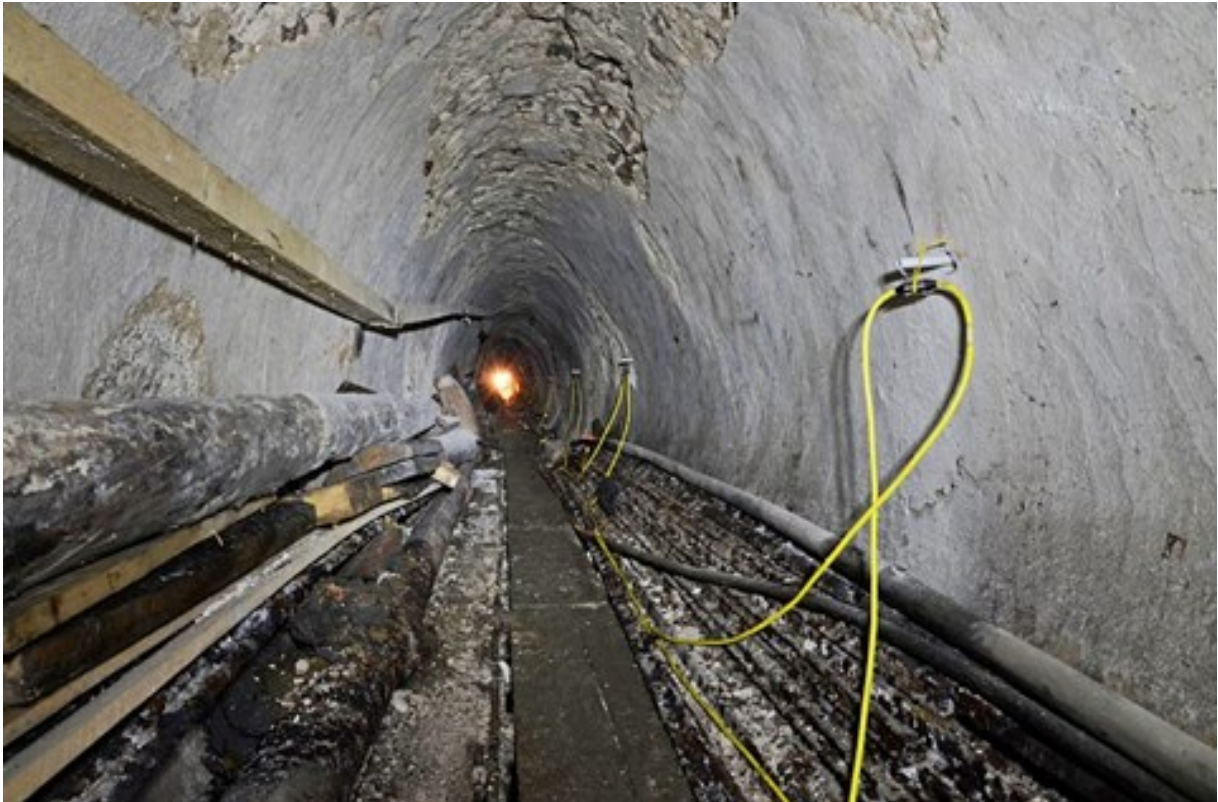
Die an den Elektroden angebrachten Messkabel im Kaiser-Josef-Stollen. Foto: Daniel Brandner
